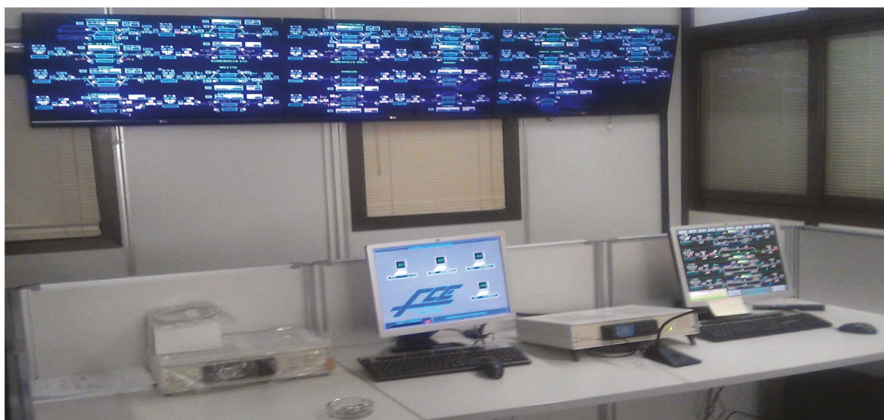
Figura 2: Sala DCO di P.C.
