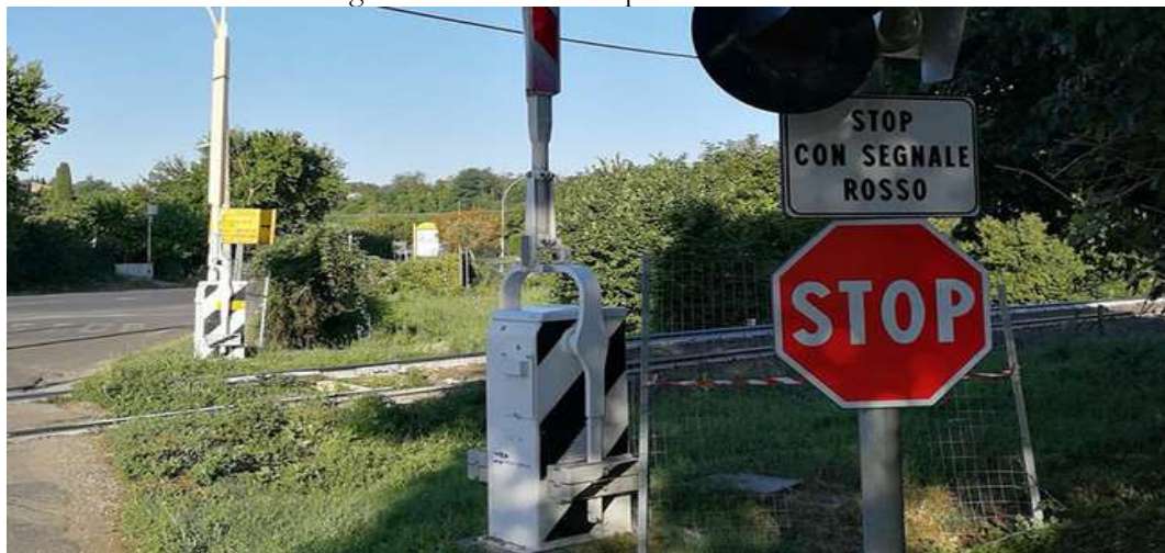
Figura 2: PL con casse di manovra TD96
