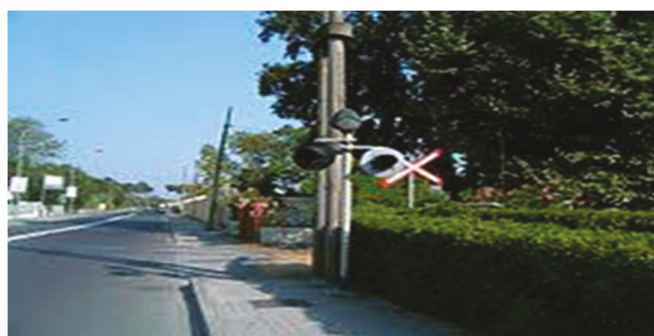
Figura 5: Dispositivi lato strada di segnalazione del PL
