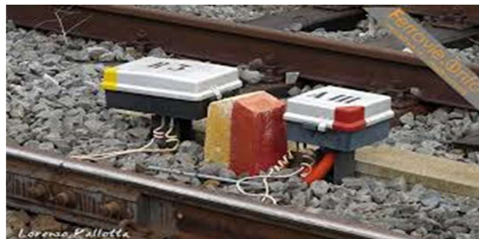
Figura 1: Cassette dei trasformatori per CdB tradizionale
