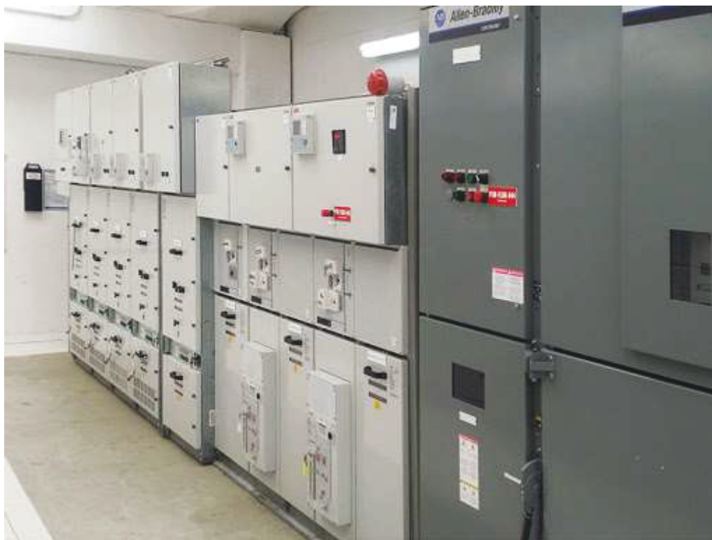
Figura 1: Cabina elettrica M.T./B.T.
