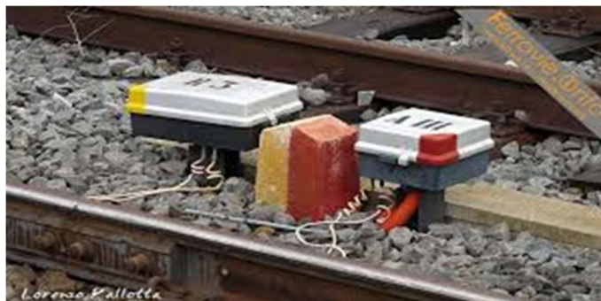
Figura 1: Cassette dei trasformatori per CdB tradizionale
