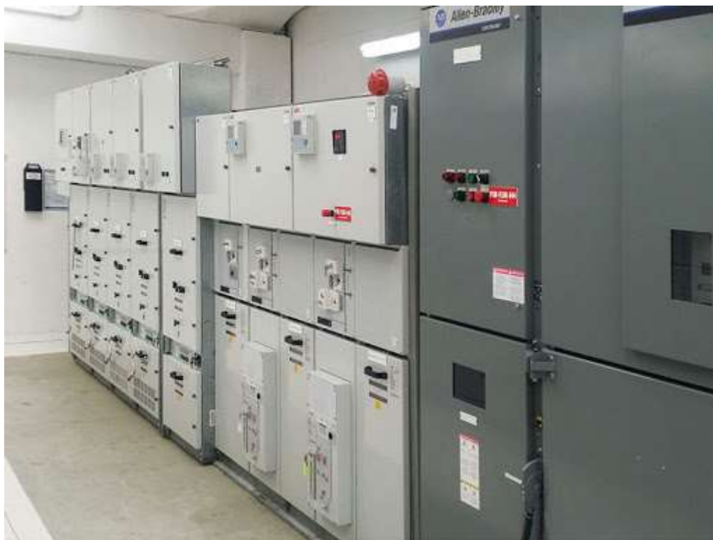
Figura 1: Cabina elettrica M.T./B.T.
