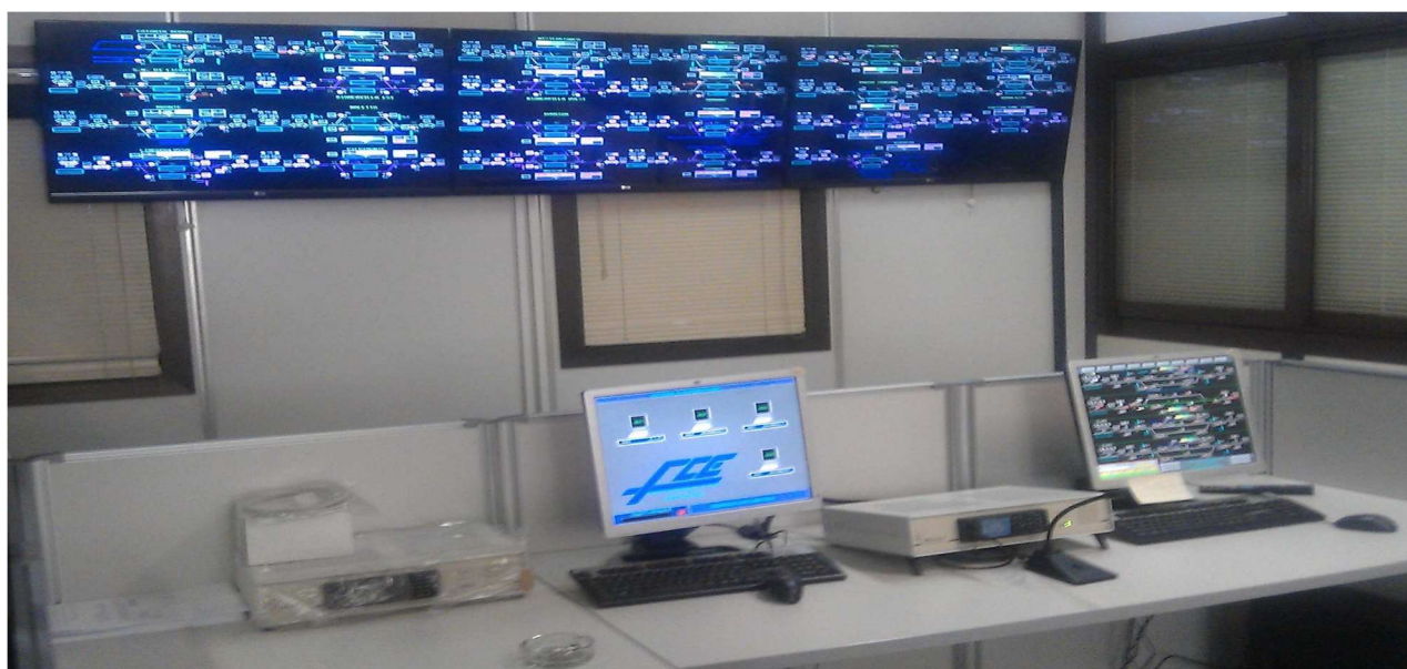
Figura 2: Sala DCO di P.C.
