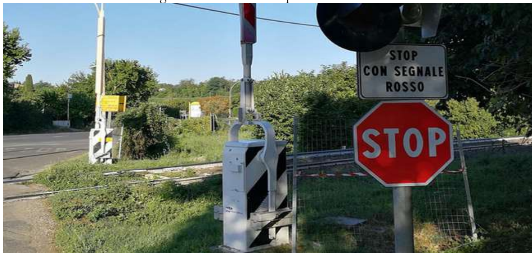
Figura 2: PL con casse di manovra TD96
